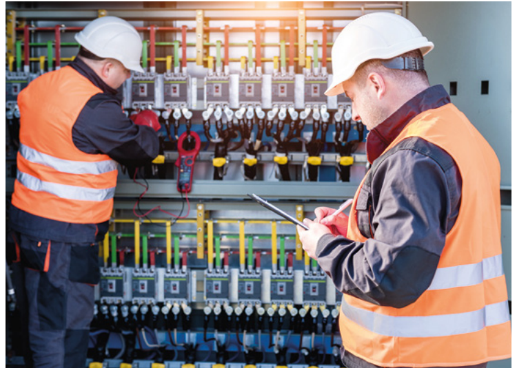
Die minütlich eingehenden Messwerte aus Ortsnetzstationen und aus den Smart-Grid-Zählern dienen der kontinuierlichen automatisiert berechneten Netzzustandsermittlung
